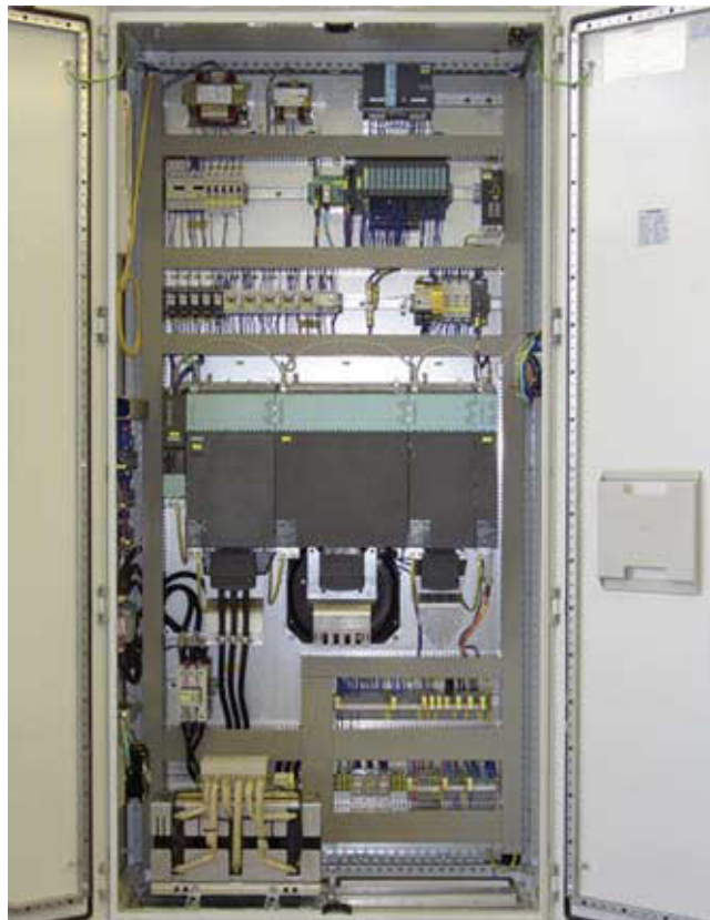
Schaltschrank mit SINAMICS S120 Bauform Booksize
