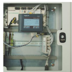
3 Fernwirkanbindung Steuerung und Abrechnung der Einspeiseleistung nach EEG
