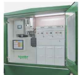
4 Standardisierte Netzeinspeisung Netzanschluss-Systemlösungen aller Spannungsebenen bis 110 kV – schlüsselfertig, wirtschaftlich
