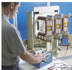
7 Ecofit Ertüchtigung und Erneuerung von Leistungsschaltern Compact und Masterpact
