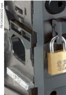
Verriegelung in der „Trennstellung“ über Vorhängeschlösser
